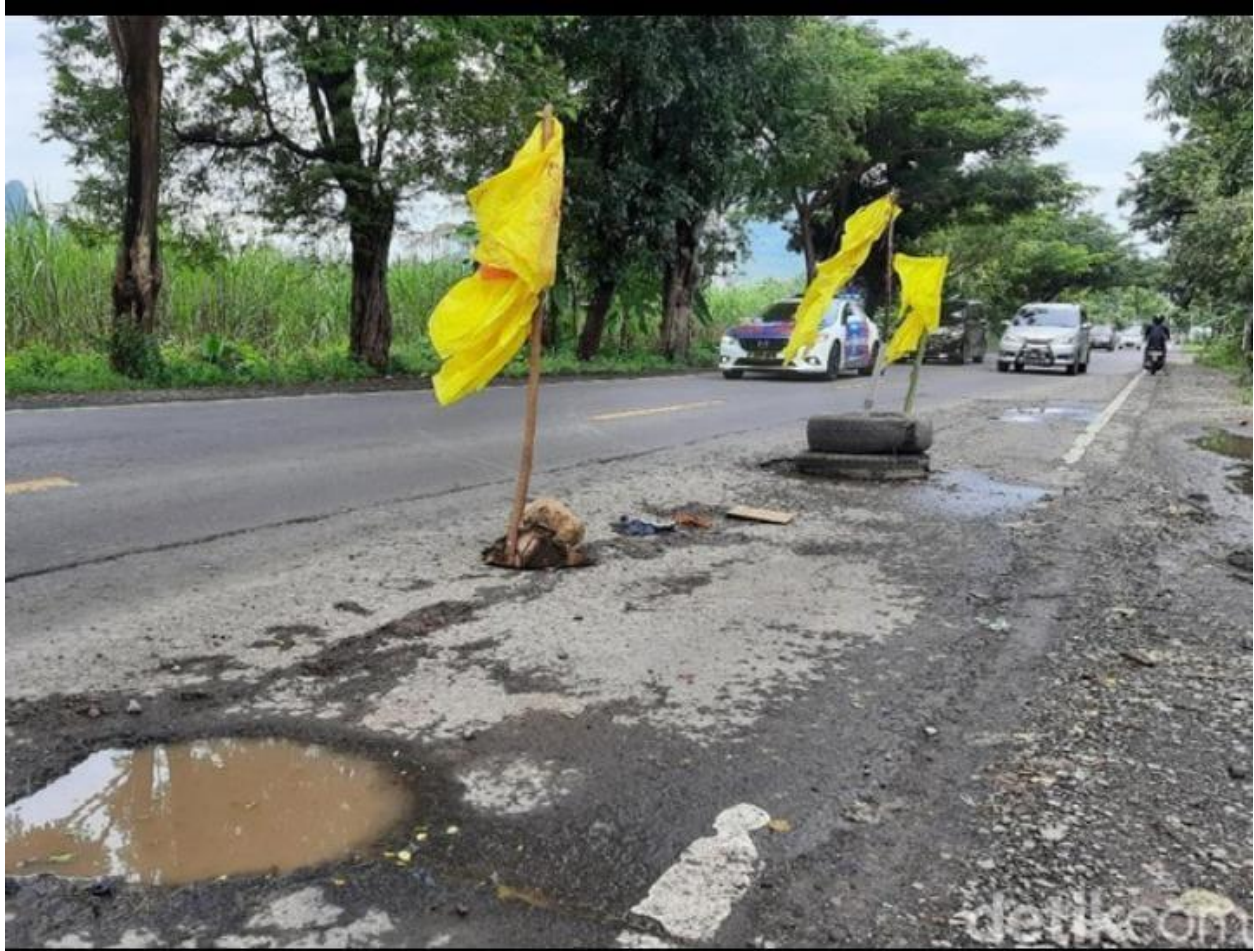
Gambar 1. Jalan berlubang di Jalur Pantura Kabupaten Situbondo
