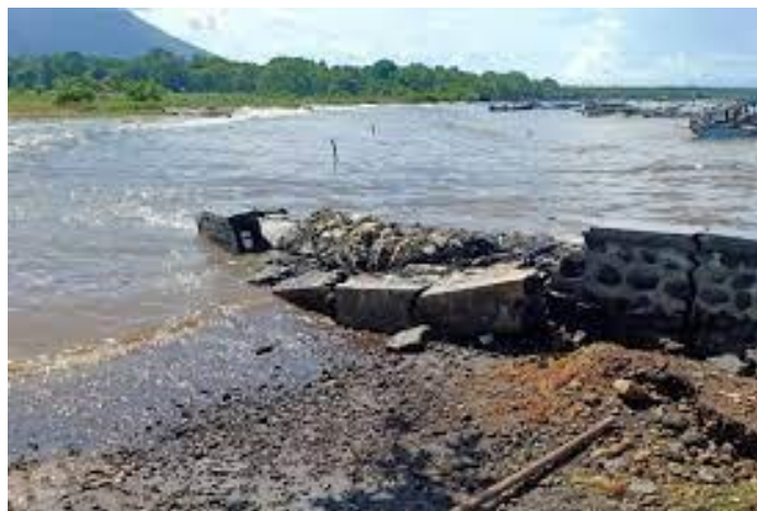
Gambar 1. Kerusakan Bangunan Tanggul Laut ( Sea dikes ) (Antaraneews.com, 2021)
