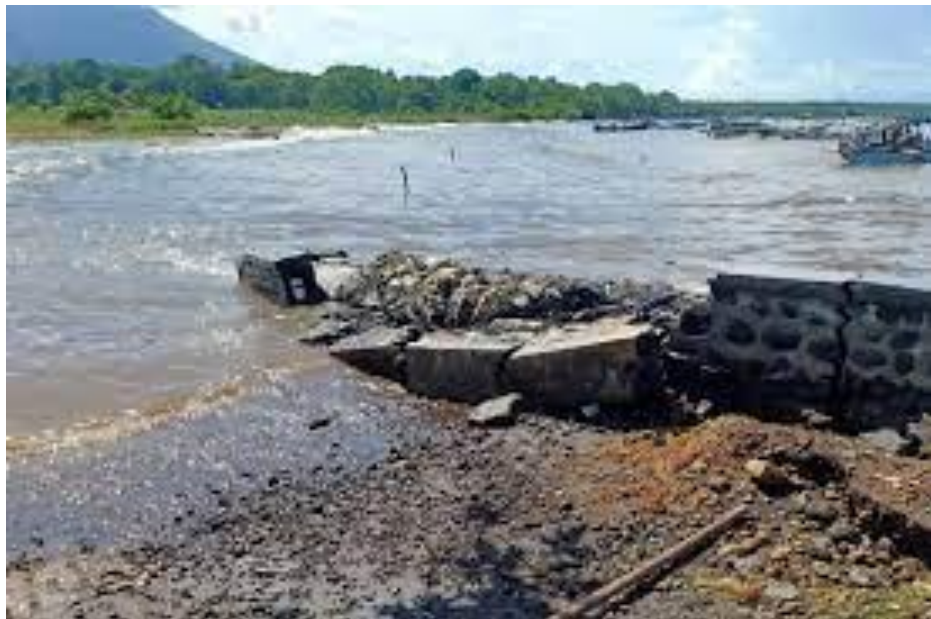
Gambar. 1.1 Kerusakan Bangunan Tanggul Laut ( Sea dikes ) (Antaraneews.com, 2021)
